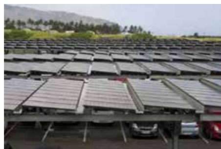
Figure 10 – Ferme photovoltaïque couplée au parking du centre commercial Jumbo Sainte-Marie Duparc 12
