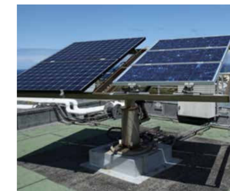
Figure 21 – Banc d'essais de différents panneaux PV
