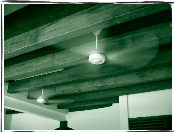
Brasseur d'air pour compléter la ventilation naturelle en cas de besoin. (Collège Saint-Laurent 3 - architecte : JAG)
