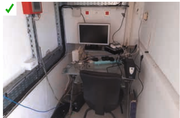
Plateforme de GTC/suivi des consommations. ©AQC
