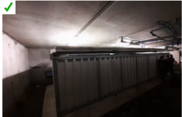
Stockage latent associé à une climatisation solaire photovoltaïque ©AQC
