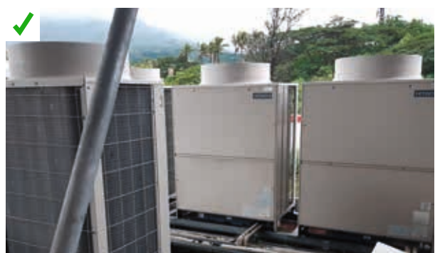
Modularité de la production de froid : plutôt que d'avoir un seul groupe pour l'ensemble du bâtiment, chaque étage est alimenté par une production distincte. ©AQC
