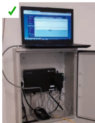
Interface de pilotage du couple production PV-demande de froid permettant de gérer au mieux la production et la consommation et d'affiner la régulation. ©AQC
