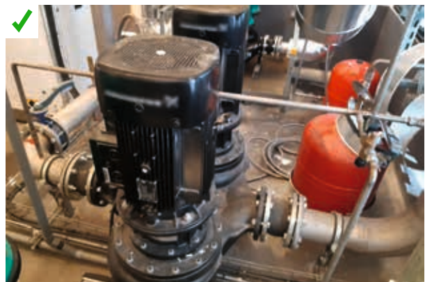
Pompes à débit variable. ©AQC
