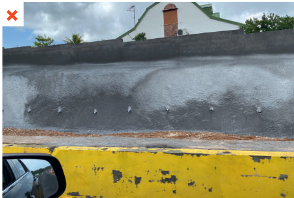
Talus minéralisé. ©AQC
