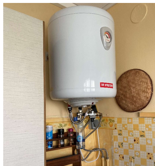
Emplacement prévu pour un ballon d'ECS électrique mais ne disposant pas évacuation d'eau, dans une résidence des années 1970. La locataire a mis une bouteille d'eau en plastique en remplacement.
