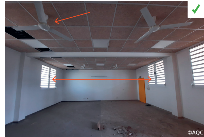
Cet espace, conçu en ventilation naturelle, dispose d'ouvertures assurant une ventilation traversante. Des brasseurs d'air ont été mis en œuvre pour assurer une vitesse d'air suffisante pour le confort des usagers.
