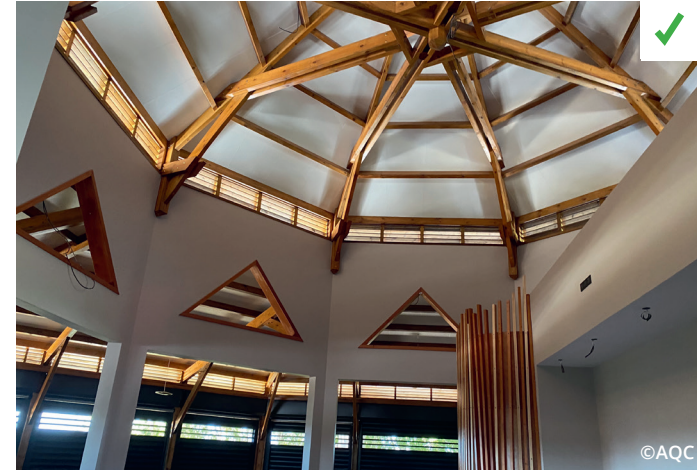
Ventelles en partie haute de l'espace permettant l'évacuation des calories.
