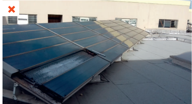
Dégradation du rendement de l'installation due à l'absence de maintenance et de remplacement des équipements endommagés. ©AQC
