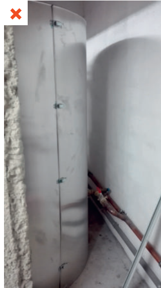
Manque de place disponible dans le local technique pour une intervention préventive ou corrective. Certains accessoires sont difficilement accessibles. ©AQC
