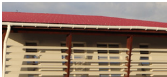
Pare - Soleil installé sur un bâtiment
