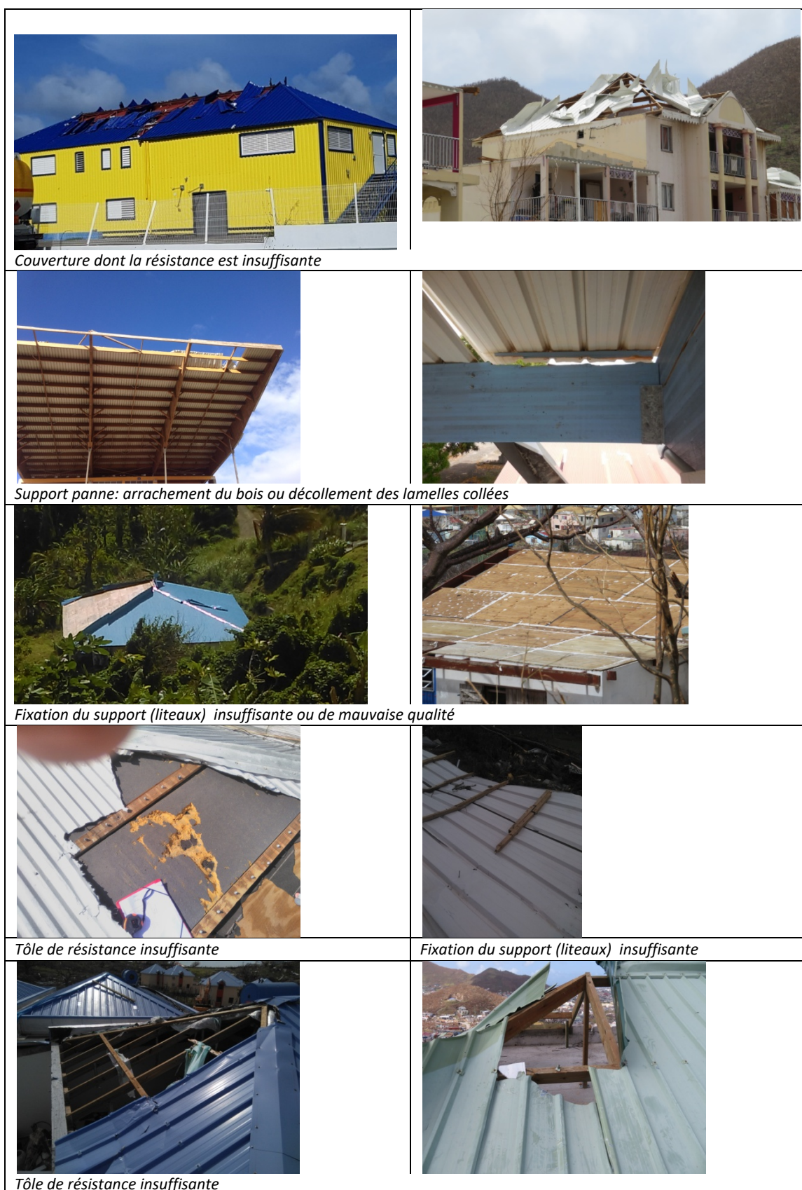
Figure 17 Illustrations par photos des dégâts de couverture
