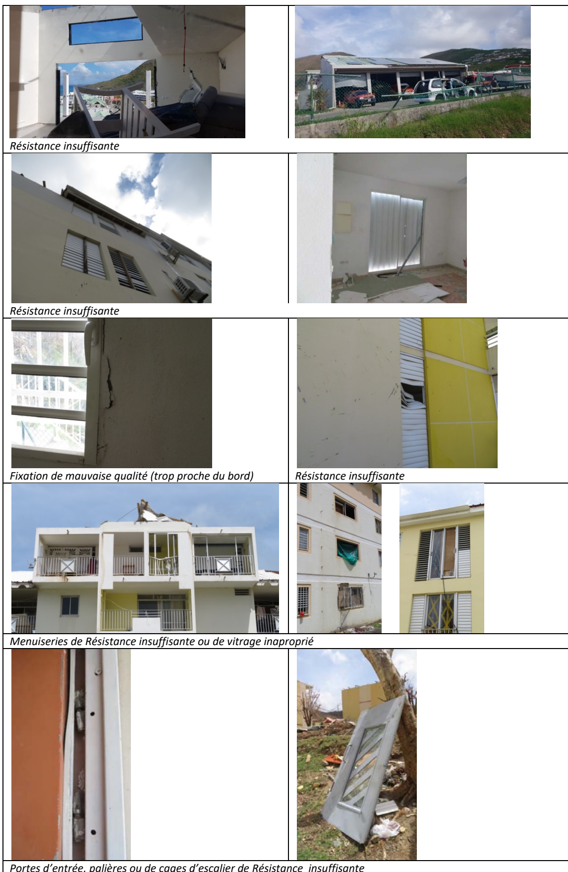
Figure 18 Illustrations par photos des dégâts de menuiseries
