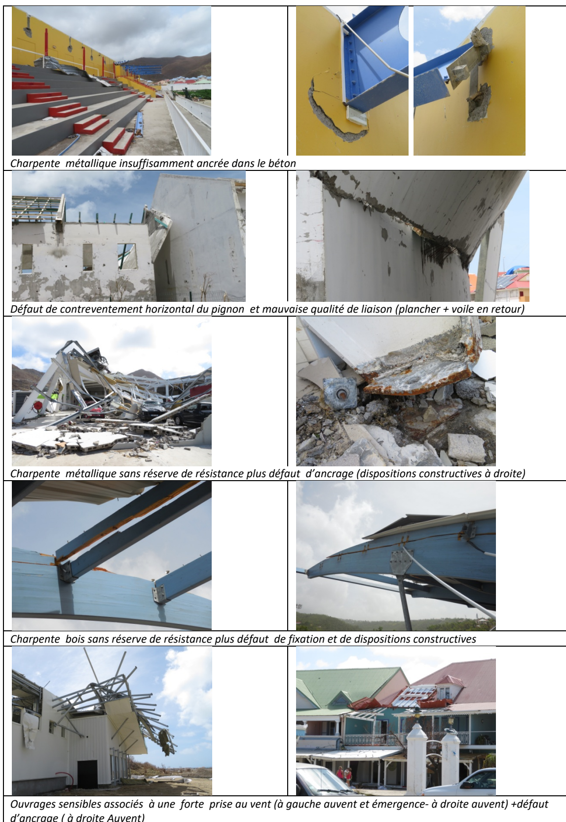
Figure 15 Illustrations par photos des dégâts sur structures
