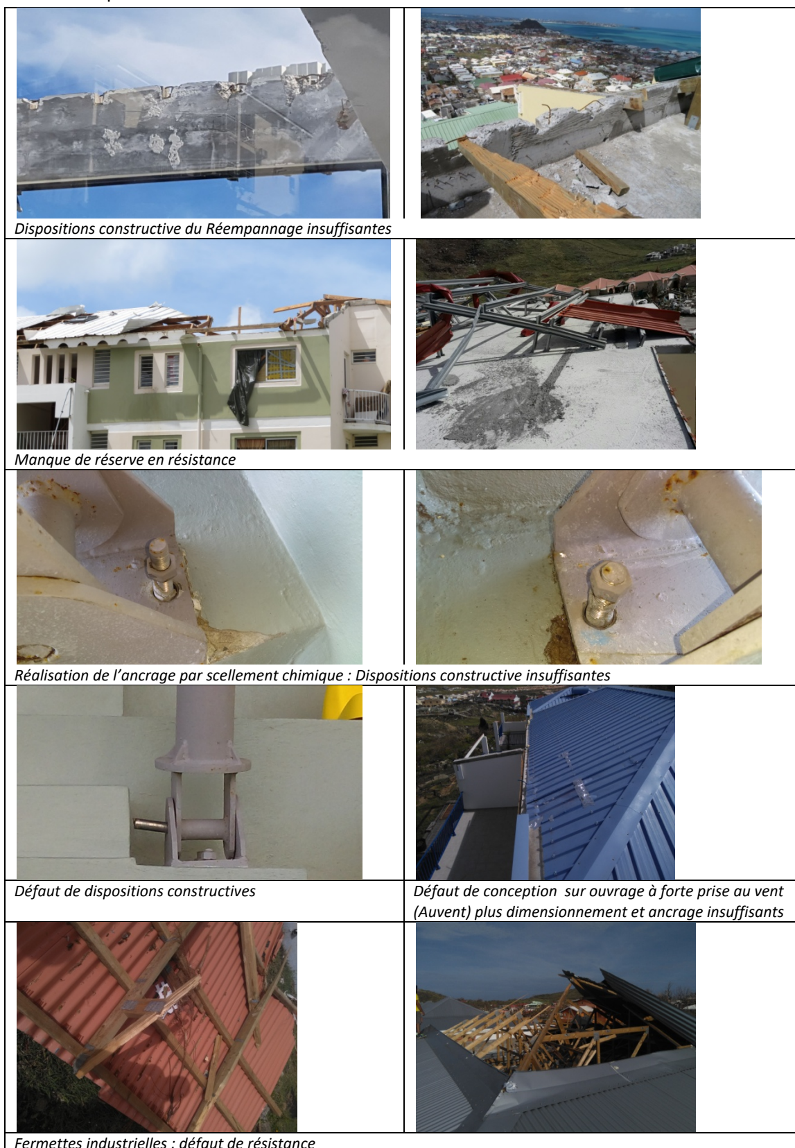
Figure 16 Illustrations par photos des dégâts de charpente de toiture
