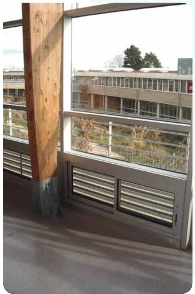
Grilles de ventilation en partie basse des circulations – Lycée Maryse Bastié - Maître d'ouvrage : Conseil régional du Limousin - Maître d'œuvre : ATELIER 4 - BE HQE : TERAQ.
