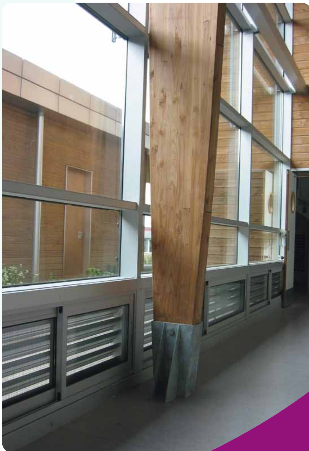
Grilles de ventilation en partie basse des circulations Lycée Maryse Bastié à Limoges
