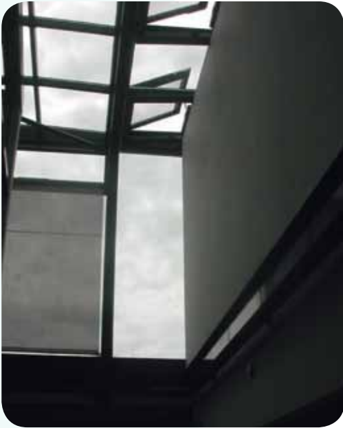
Sorties d'air en partie haute.
