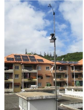
Anémomètre en toiture
