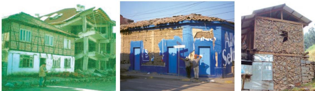
Effets des séismes : a) Turquie 1999, construction vernaculaire faiblement endommagée à côté d'un bâtiment en béton armé effondré (source: DOĞANGÜN, TULUK, LİVAOĞLU, et al.) ; b) El Salvador 2001, détachement des enduits (crédits: A. Douline); c) Pakistan 2005, chute d'une portion de remplissage (crédits: T. Schacher)
