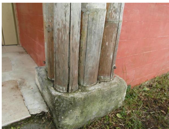
Figure 18: Dommages fongiques, fissures et blanchiment du bambou traité au bore exposé au soleil et à la pluie après environ 10 ans
