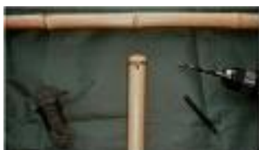
Les bambous ne subissent pas d'importante perforation.
