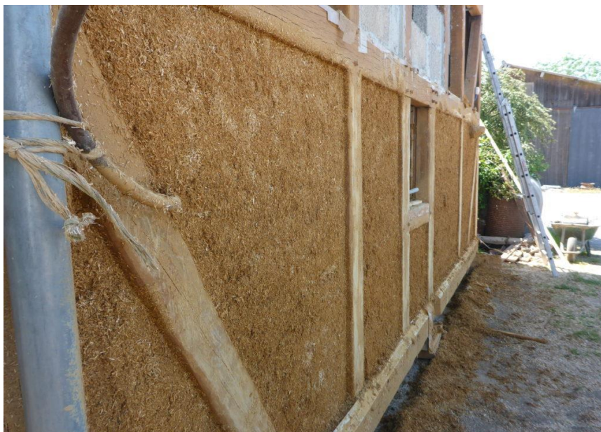
Figure 14: Exemple de mise en oeuvre de terre-chanvre projeté en isolation par l'extérieur. Normandie, Eco-Pertica
