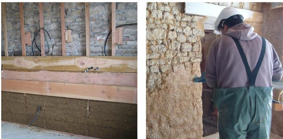
Figure 13: Exemple de chantier de terre chanvre. Gauche, banchage ; droite, projection. (Crédits A. Hellouin de menibus)
