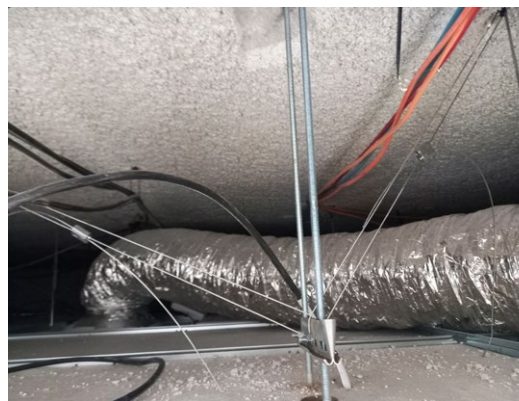
Fixation faux plafond à l'aide de tiges filetées « spitées » dans le béton
