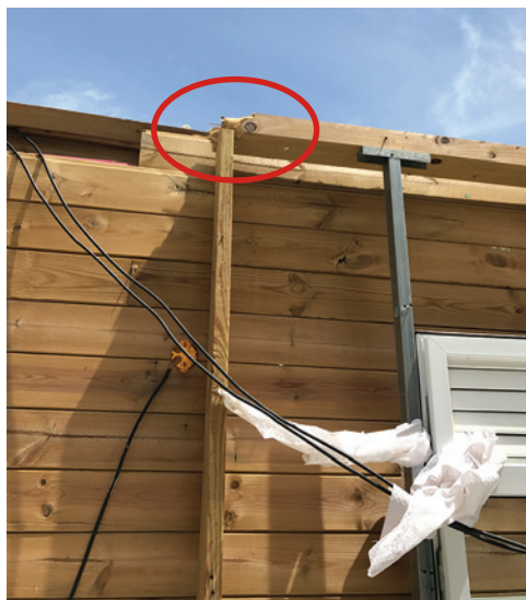
Figure 1 : Section probablement insuffisante (CAUE)
