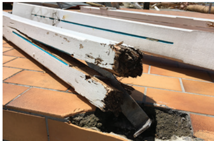
Figure 6 : Poteaux avec équerres arrachées
