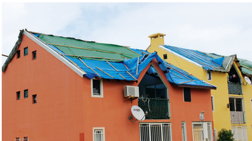
Figure 1 : Désordres sur couvertures
