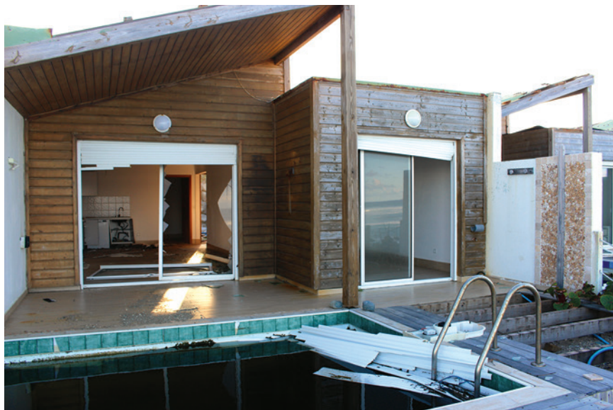
Figure 2 : Désordre sur les baies vitrées
