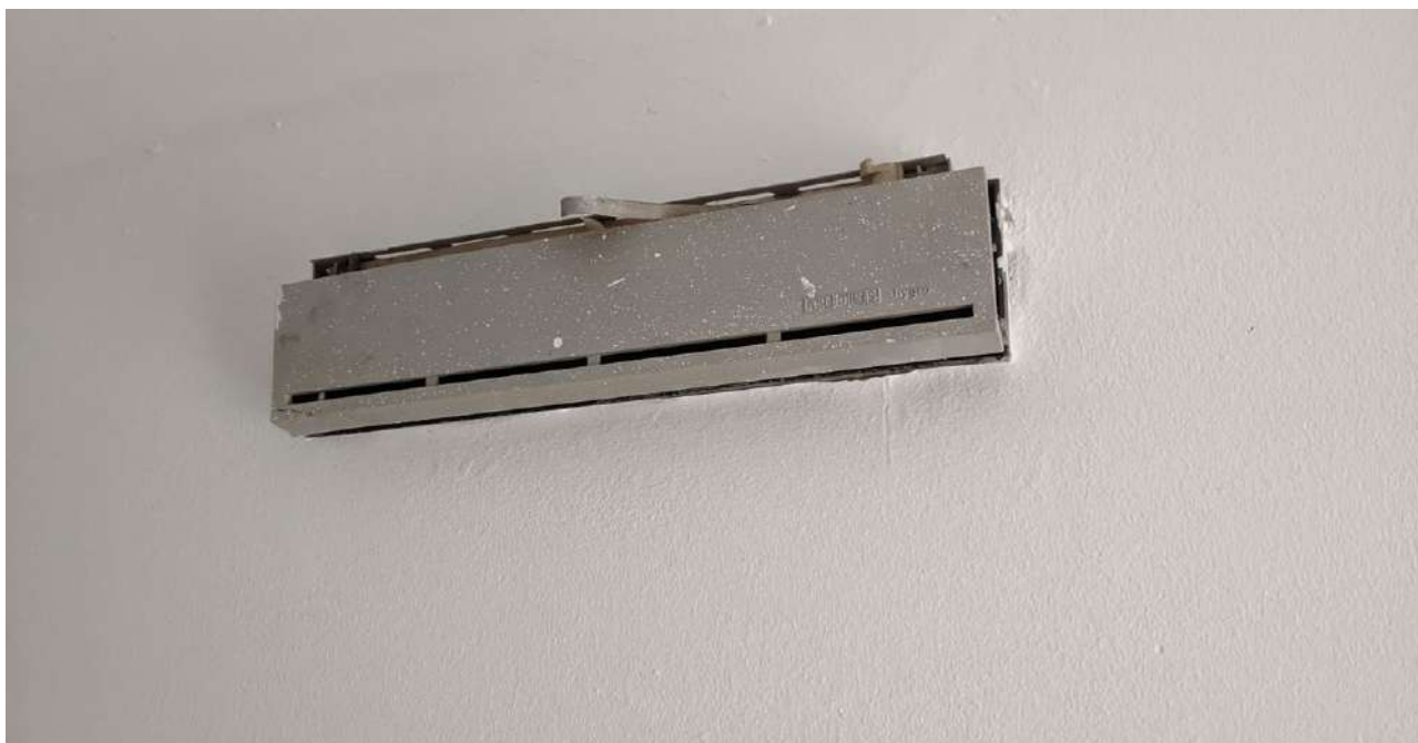
Une entrée d'air qui mériterait un remplacement
