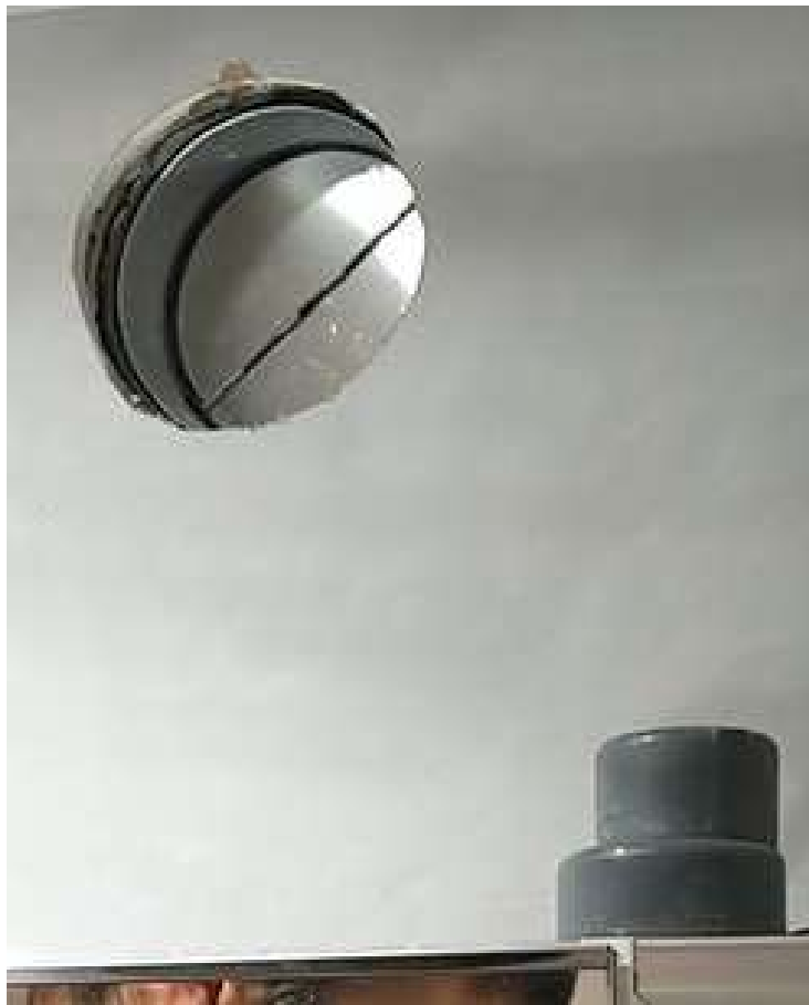
Une bouche obstruée par un ingénieux dispositif amovible
