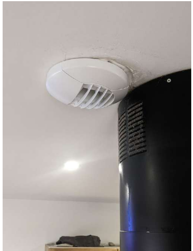
Une hotte en concurrence avec la ventilation
