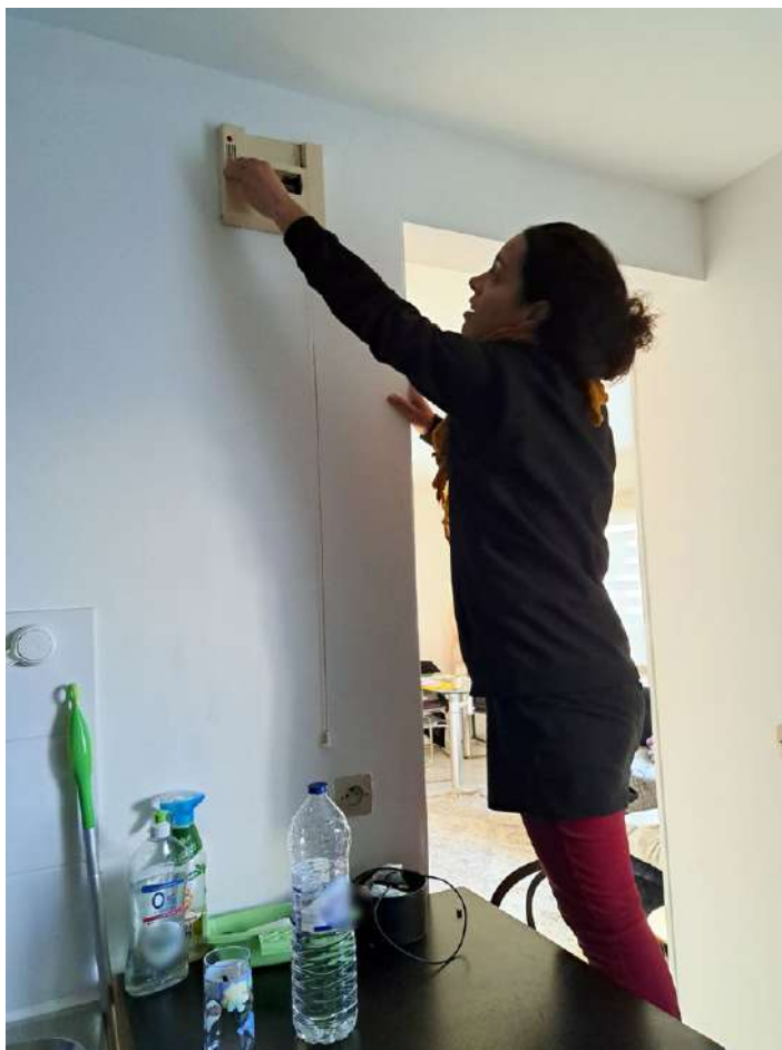
Tentative infructueuse de démontage d'une bouche
