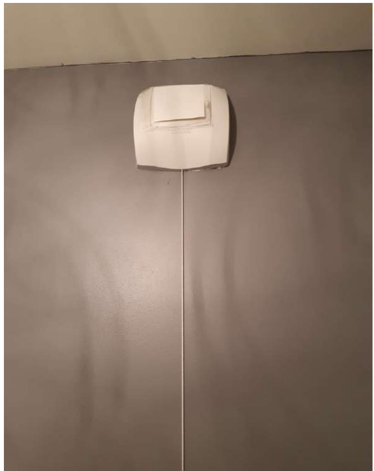
La VMC bouchée dans les toilettes
