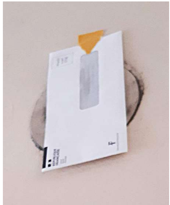
Une bouche obstruée par une simple feuille
