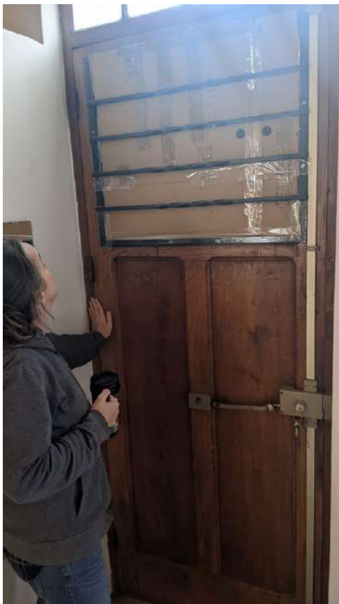
Des fuites d'air qui disqualifient l'aération hivernale
