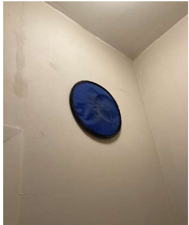
Une ventilation de WC obstruée
