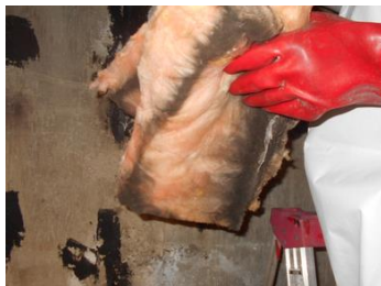
Moisissure de la laine minérale à cause de l'humidité
