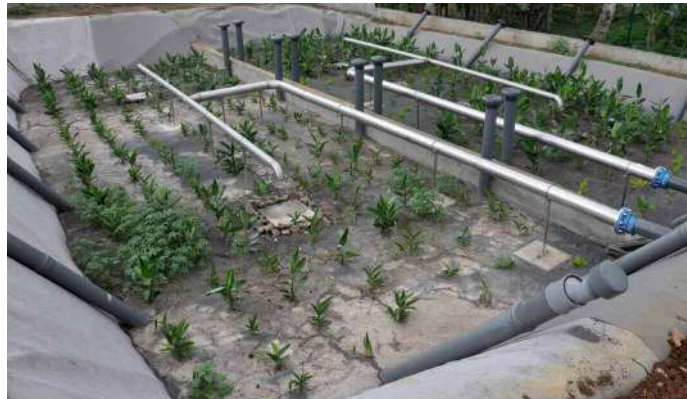
Figure 20. Cloison de séparation de 2 filtres dans le même casier. On remarque qu'elle aurait pu être un peu plus haute (20-30 cm) pour ménager une hauteur de revanche plus importante. Station de Champ d'Ylang 1, lors de son inauguration en novembre 2015, commune de Combani (Mayotte).
