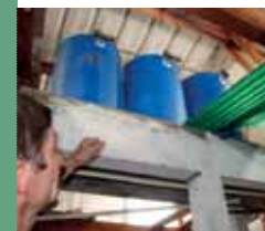
Guy Favand et son chauffe-eau solaire artisanal
