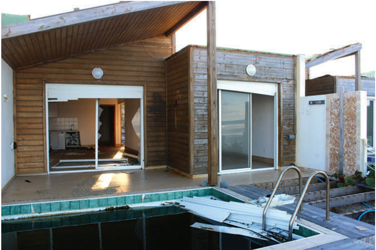
Figure 2 : Désordre sur les baies vitrées
