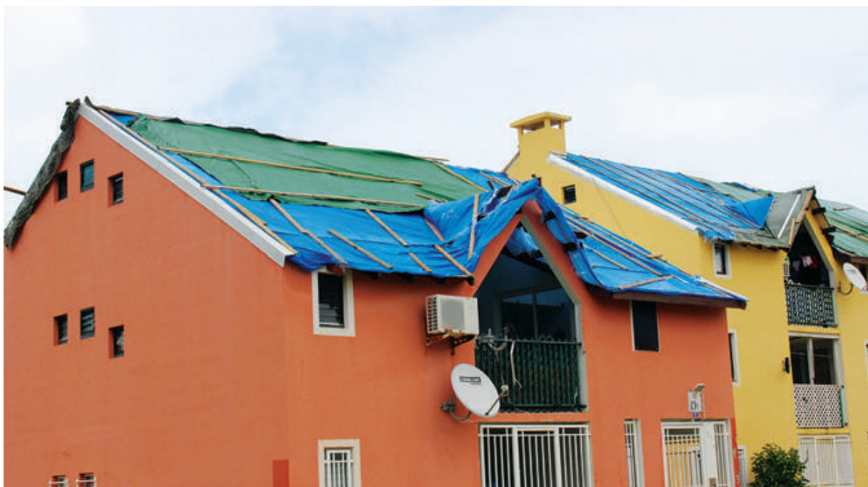
Figure 1 : Désordres sur couvertures
