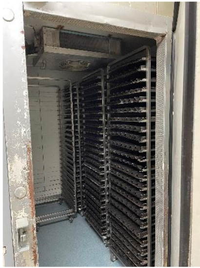
Chambre froide dans une boulangerie
