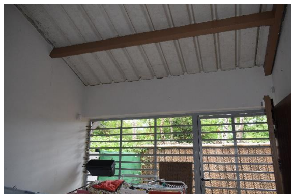
Opération Ylang 3 : varangue couverte par une tôle non isolée
