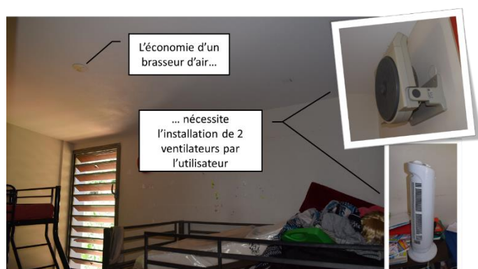
Opération Kenaparis : une attente au plafond mais les occupants ont mis en œuvre un brasseur d'air mural et un autre sur pied à la place
