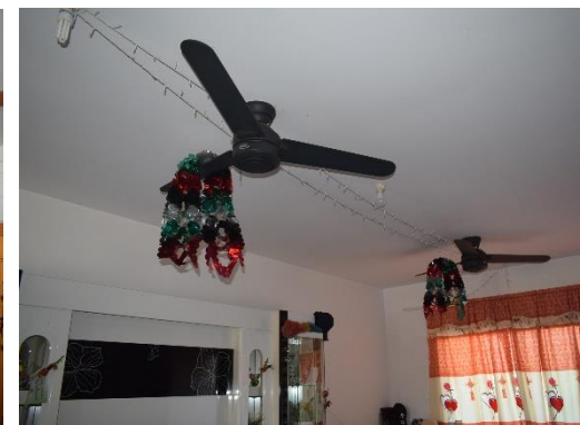
Opération Apollo : brasseurs d'air non utilisés (guirlandes) et disjoncteur tombé
