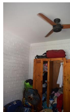
Opération Pégase : brasseur d'air de faible diamètre et ventilateur sur pied à la place
