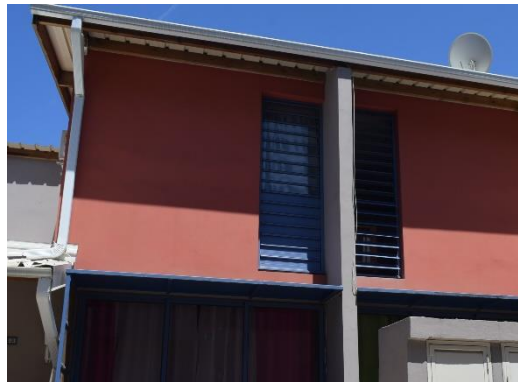
Opération Tamarins les Bas : lames opaques en partie basse munies de lames opaques de couleur foncée – sources d'inconfort (augmentation de la température radiante)
