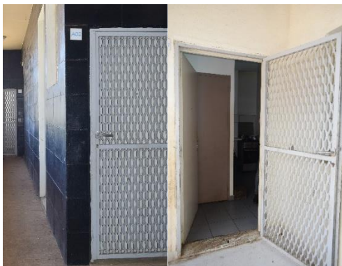
Opération Apollo : sur cette opération, les doubles portes sont très utilisées car la porte en métal déployée empêche la vision depuis la coursière vers l'intérieur du logement.
