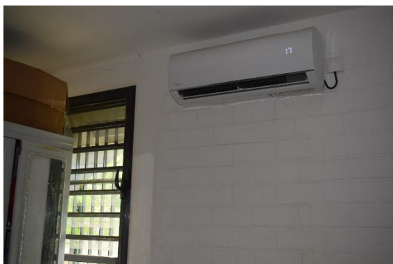
Opération Trevani : consigne à 17°C et fenêtre ouverte
