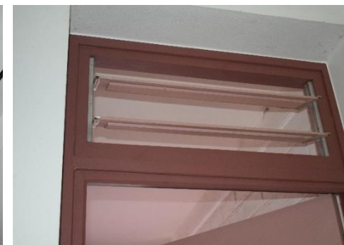
Opération Pégase : dans ce logement, les impostes au-dessus des portes ont été observées ouvertes.
