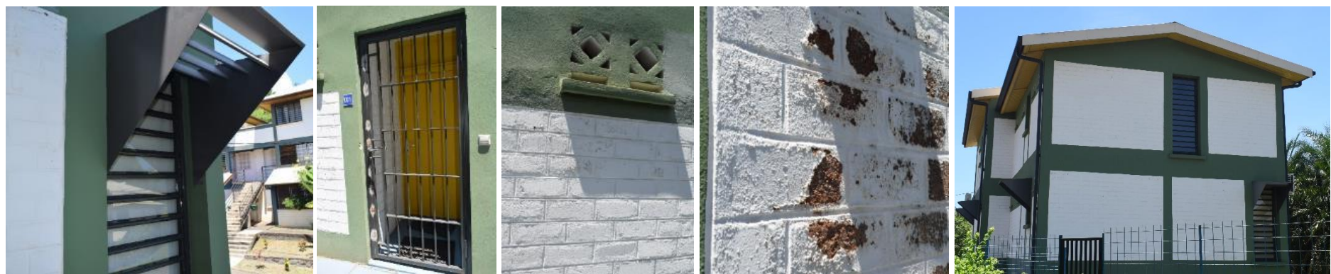
(1) Casquettes persiennées sur les baies des chambres. (2) Porte des logements grillagées mais la porte pleine est généralement fermée. (3) Moucharabieh sur les coursives + nacos à l'intérieur des logements. (4) Murs en BTC abimés. (5) Jalousies non protégées en pignon.
