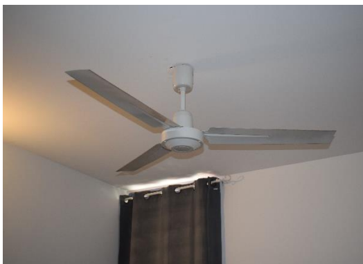
Opération Tamarins les Bas : brasseur d'air en métal et pales non inclinées
