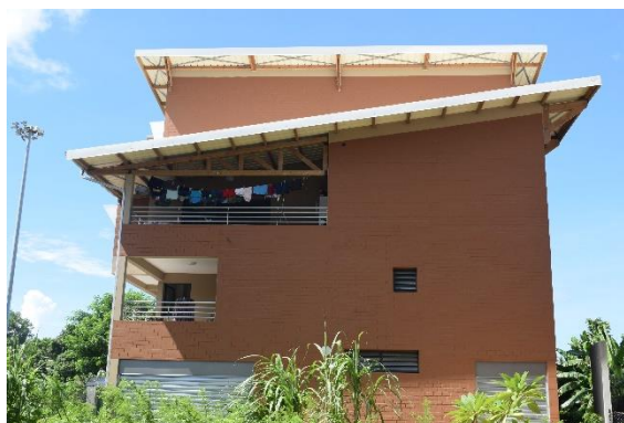
Opération Jardins : toiture de la varangue non isolée au dernier niveau
