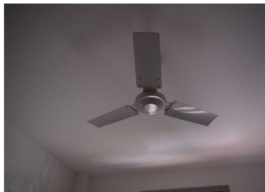
Opération Bengalis : brasseur d'air de faible diamètre
