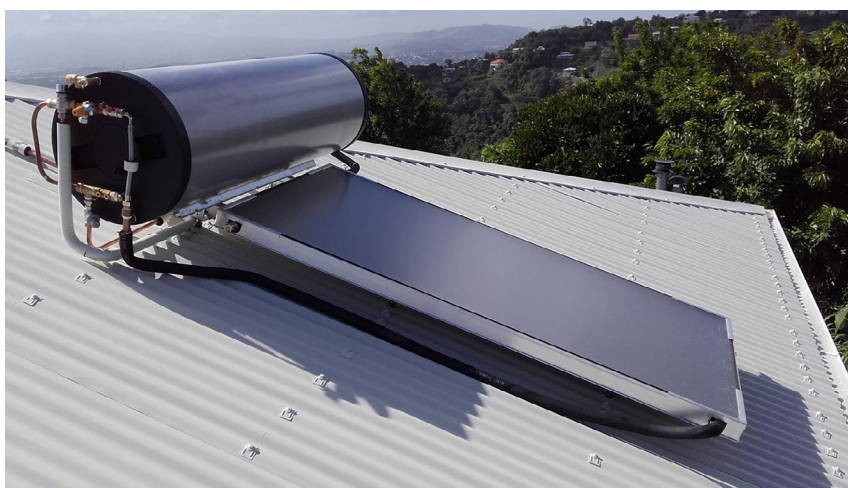
Figure 157 : CESI à thermosiphon sur toiture tôle
