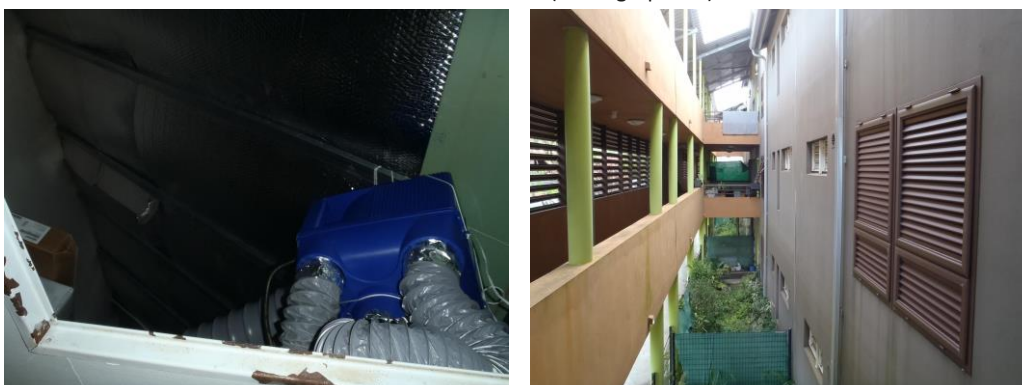
Photographie 4 : Mise en évidence de présence d'une VMC Simple flux dans les combles et mise en évidence de masques créés par les coursives sur une des façades
