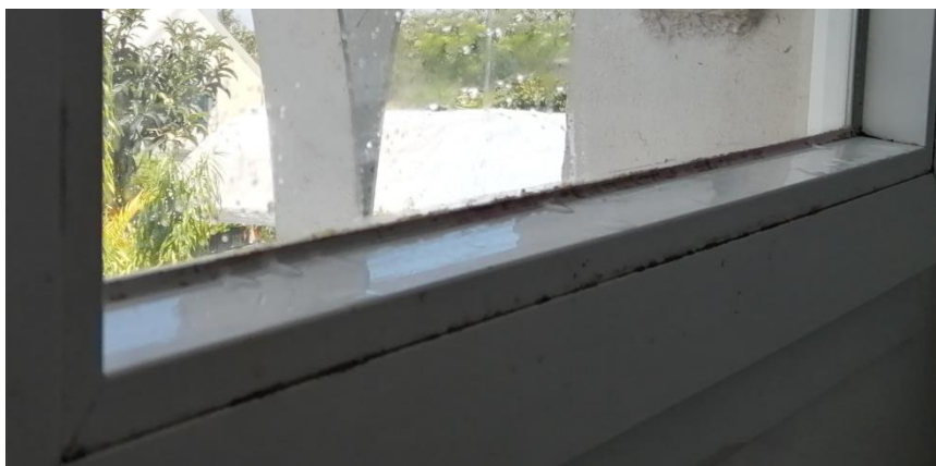
Photographie 17 : Développement de moisissures sur une menuiserie dû à la condensation de l'humidité intérieur sur le vitrage et aux ponts thermiques
