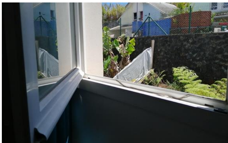
Photographie 18 : Défaut du joint d'étanchéité entre la partie mobile et le cadre de la menuiserie
