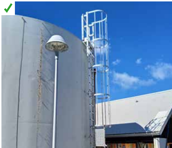
Accès sécurisé avec une échelle à crinoline. ©AQC
