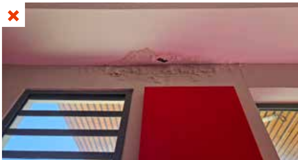
Infiltration sous toiture végétalisée. ©AQC
