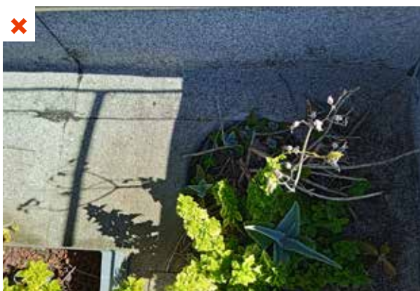
Développement de végétaux sur la zone stérile à proximité de l'évacuation des eaux pluviales. La présence de végétaux ne permet pas de contrôler l'intégrité de l'étanchéité au niveau de la zone stérile et des relevés d'étanchéité. Le développement des végétaux risque d'altérer l'étanchéité et ne permet pas une bonne évacuation de l'eau de pluie. ©AQC
