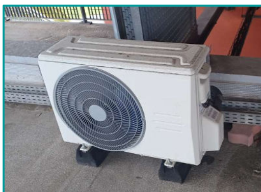
Unité extérieure d'un climatiseur split
