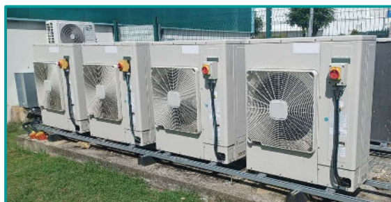
Installation VRV en bâtiment tertiaire
