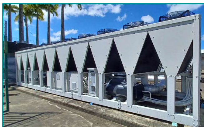
Groupe de climatisation à eau glacée à condensation par air
