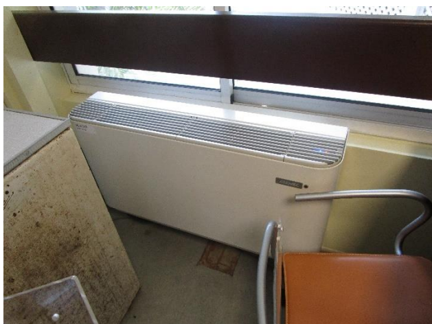
Photo 24 - Ventilo-convecteur de groupe à eau glacée
