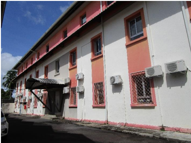
Photo 26 - Vingtaine d'unités extérieures de splits-systems en façade
