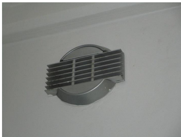
Photo 31 - Bouche de soufflage de VMC
