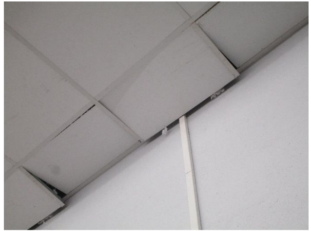
Photo 7 - Isolation en ouate trop lourde pour faux-plafond
