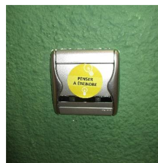
Photo 59 - Message sensibilisation sur interrupteur de circulation
