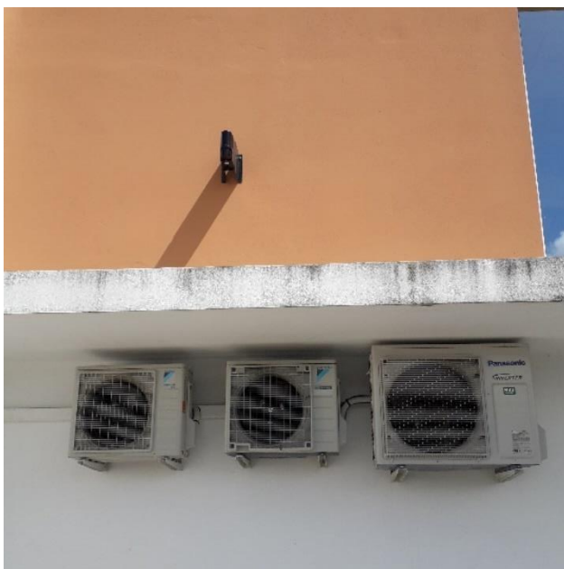
Photo 28 - Unités extérieures protégées sous auvent
