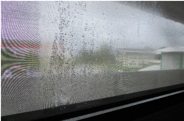
Photo 57 - Phénomène de condensation dans une salle de réunion due à un soufflage direct sur le vitrage à une température trop basse
