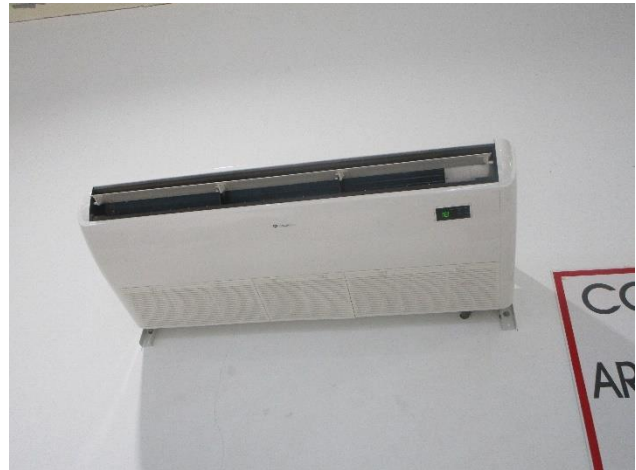
Photo 27 - Unité intérieure en console dans un commerce
