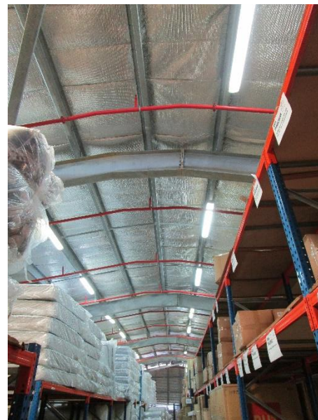
Photo 48 - Réglettes de tubes fluorescents dans une réserve
