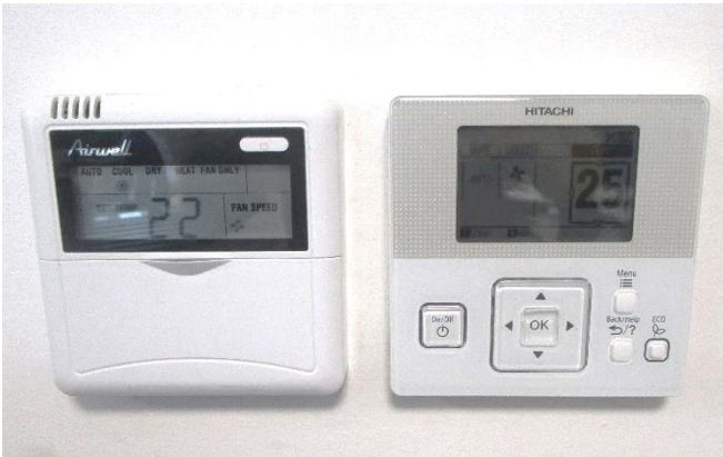
Photo 56 - Exemple de gestion différenciée de la température de consigne au sein d'un même bâtiment
