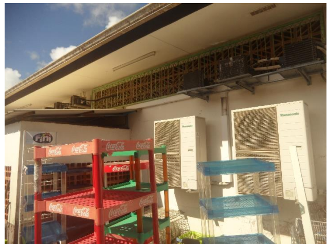
Photo 38 - Groupes froid déportés (en hauteur, au-dessus des unités de climatisation)
