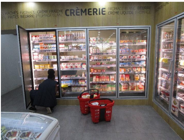
Photo 37 - Vitrine de froid positif fermée sur chambre froide
