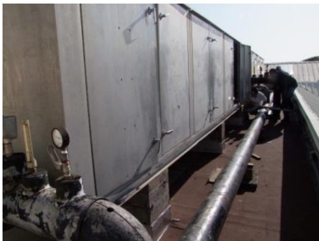
Photo 20 - Groupe de production d'eau glacée
