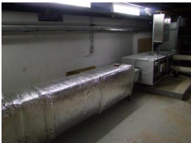
Photo 30 - Centrale de traitement d'air
