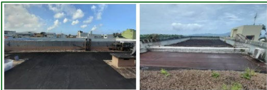
↑ Toitures terrasses sombres non isolées
