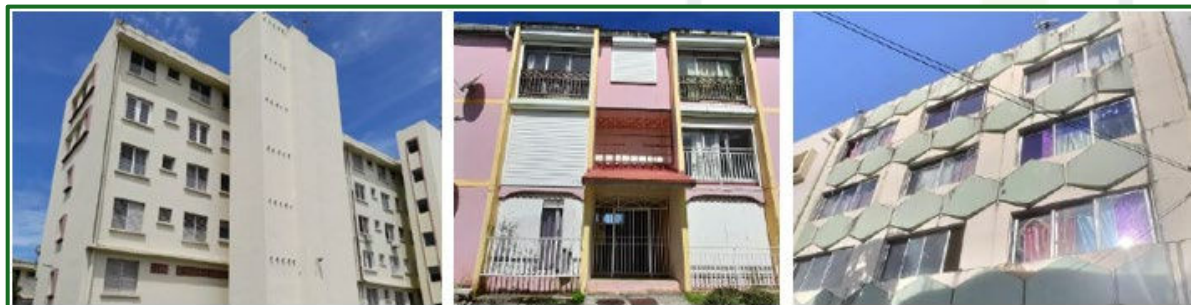
↑ Défauts de protection solaire
