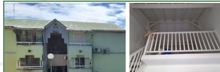
↑ Toitures tôles non isolées
