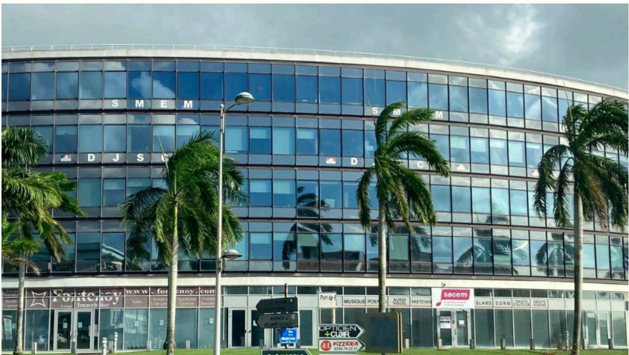
Mur rideau surexposé (Centre d'affaires Agora 2 - Martinique - Architecte Grandgeorge Architecture et Bernard Leclercq , photo : Équinoxe)
