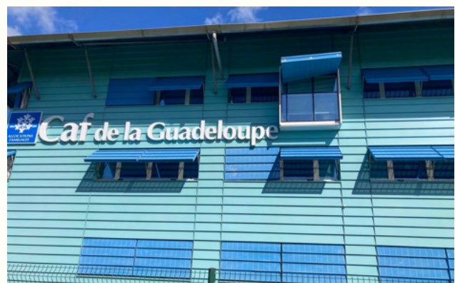
Photo Décembre 2025 (13 ans après), de nombreux vérins sont dysfonctionnels...
