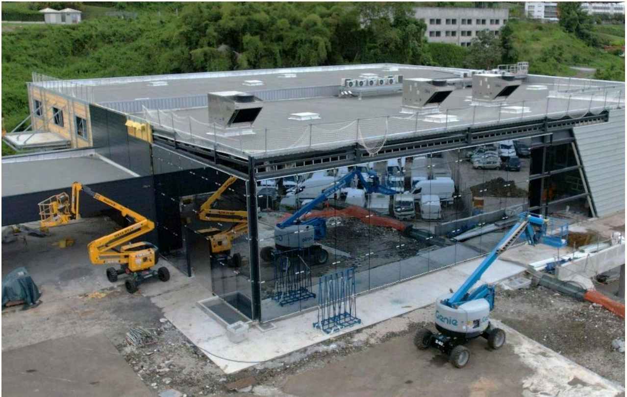
Exemple de construction en cours en 2025, zone commerciale ACAJOU Mur rideau « radiateur » et systèmes de climatisation surdimensionnés - Martinique -
